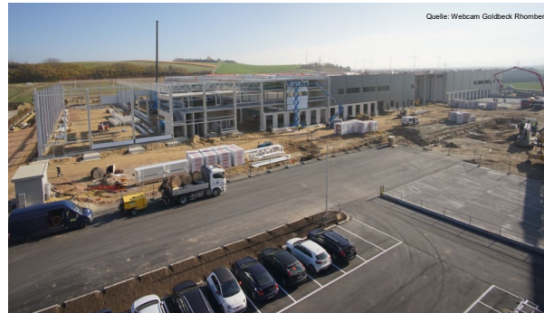
Industrial Campus Vienna East (Österreichs größter Logistikpark), Enzersdorf a. d. Fischa: Generalplanung
